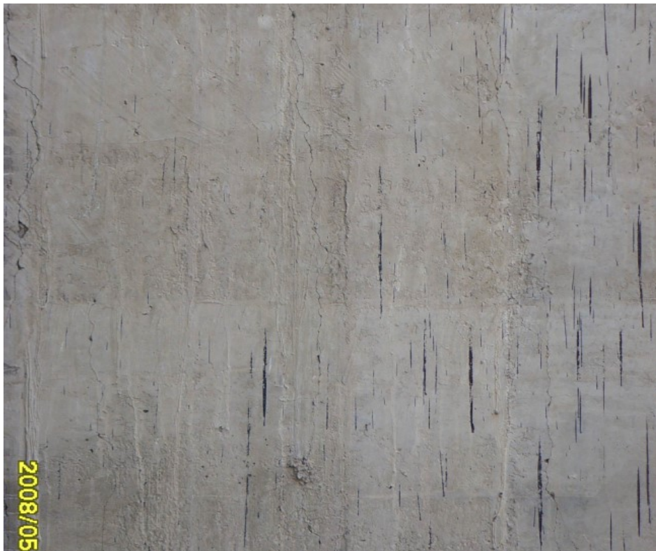
图 1 2008 年 5 月库体外侧裂纹照片
