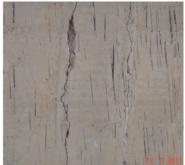
图3 局部裂缝照片
